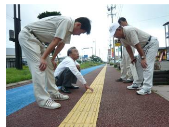
実験実施箇所でも材料見積りのための計測や冬期の凍結などを考慮した施工方法の検討などを行いました。
