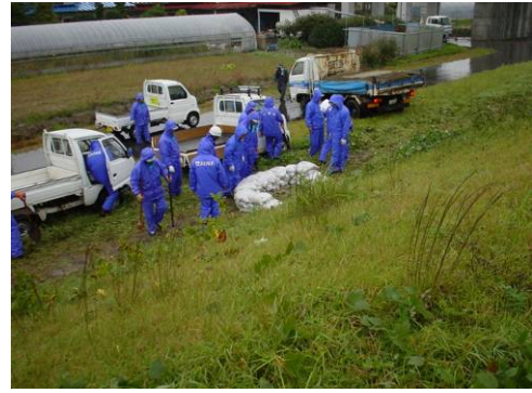
写真 2-24 漏水による水防活動の状況
