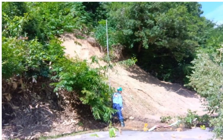
先遣調査班⑥-1 被災状況調査(山形県舟形町)
