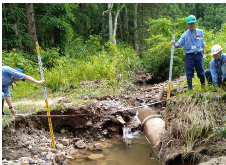
先遣調査班⑥-1 被災状況調査(山形県舟形町)
