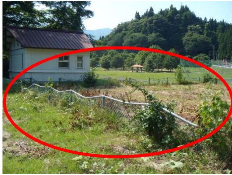
②荒雄湖畔公園(木製標識支柱の腐食・ぐらつき)
