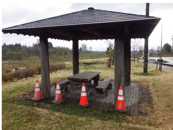
東屋床版腐食 応急対策状況(野川まなび館)
