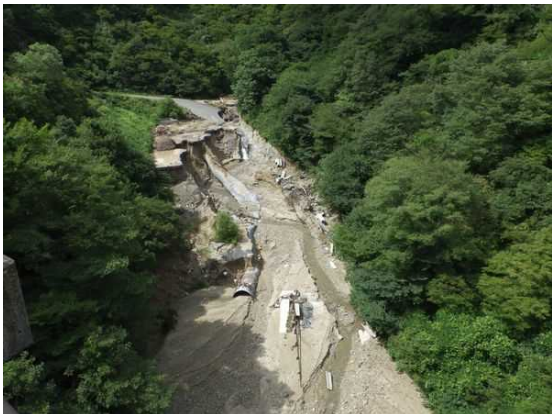
(管理用道路崩壊状況)
