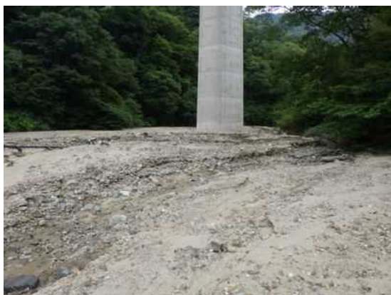
(土砂堆積状況)
