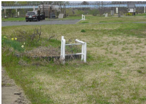
(措置前)車止めの損傷
