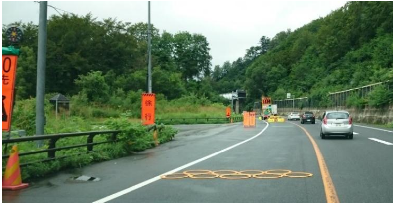
■ オレンジ色の表示板の設置状況
