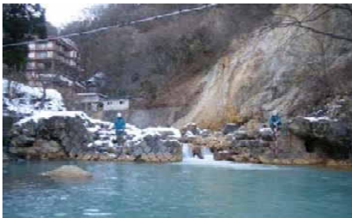
床固(石積流出箇所)
