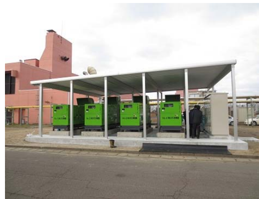
【バイオガス発電設備(新潟浄化センター)】
