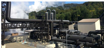
出典：経済産業省 資源エネルギー庁 山葵沢地熱発電所
