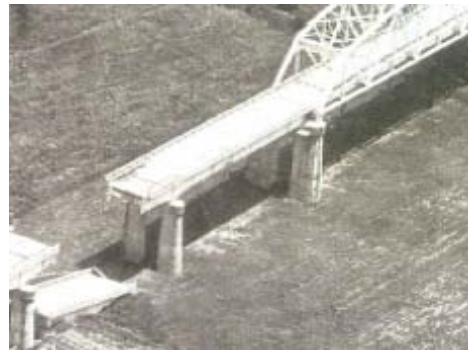
宮城県沖地震(昭和53年)の被害(落橋した錦桜橋)
