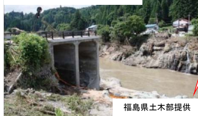
豪雨による落橋 (福島県大沼郡金山町)
