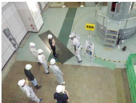
四十四田発電所の内部
