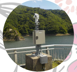
更新後のCCTV (2023年7日撮影)
