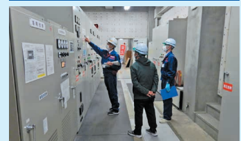
電気室の設備状況の確認
