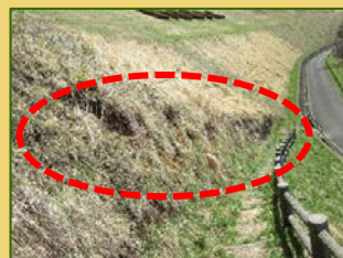
落石の危険があるため進入禁止にしました
