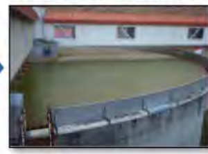
固液分離槽 (有害な鉄やヒ素が酸化物となり無害となった上澄みが川へ)
