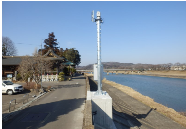
洪水時の状況を把握するCCTVカメラ
