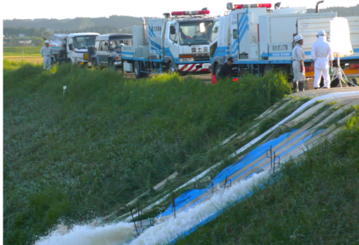
桧和田排水機場での排水ポンプ稼働状況 (吉田川左岸23.6k付近)
