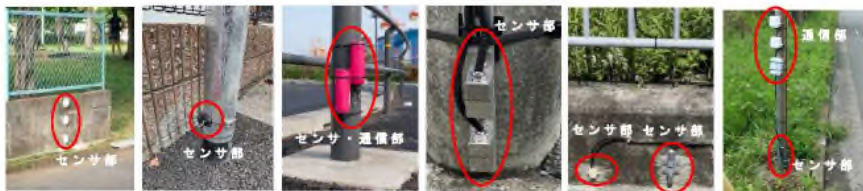
実証実験で設置した浸水センサの設置事例
