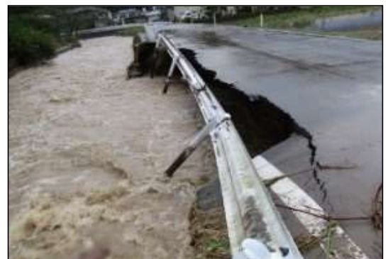
令和元年東日本台風（台風19号）による南沢川護岸および県道の崩壊状況（登米市）
