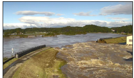
吉田川左岸の堤防決壊（大郷町粕川）
