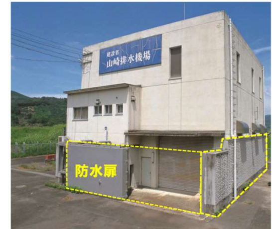
排水機場の非浸水化事例 山崎排水機場 (牛津川 (佐賀県)) では、コンクリートによる防水壁を設けた。
