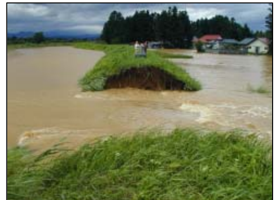
平成14年7月洪水で破堤した二迫川（栗原市栗駒）
