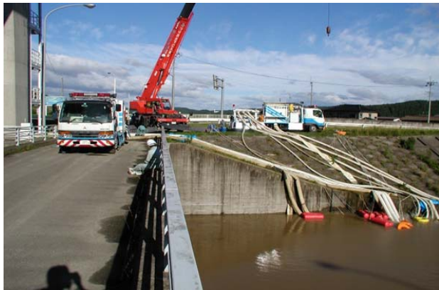
排水ポンプ車による排水作業（北上川下流南沢川水門）
