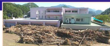
平成28年台風10号により、岩手県の要配慮者利用施設では利用者9名の全員が死亡。
