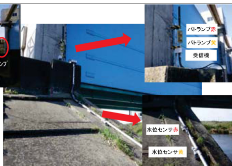
簡易アラート設置状況（H28.11.2）
