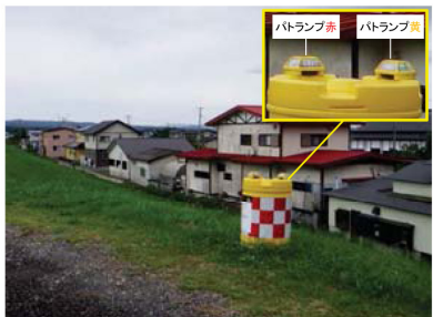
簡易アラート設置状況（H28.10.31）
