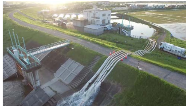
大崎市古川米袋付近における排水ポンプ稼働状況 (多田川左岸2.6k付近)
