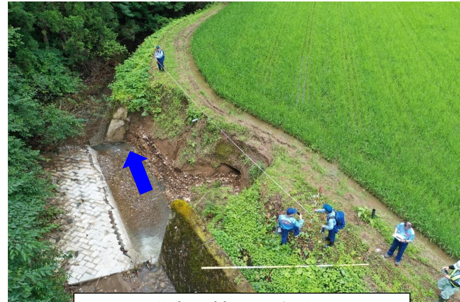
護岸の被災調査状況
