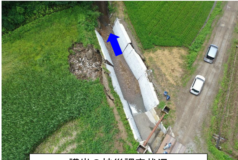
護岸の被災調査状況
