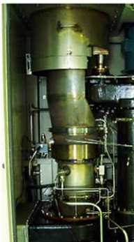
ガスタービン（外観）
