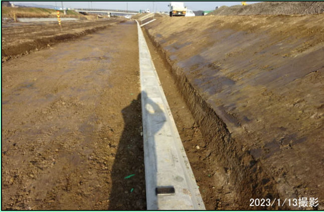
①越流堤部（川表） 越流堤本体工（プレキャスト基礎据付、埋戻し） 施工中
