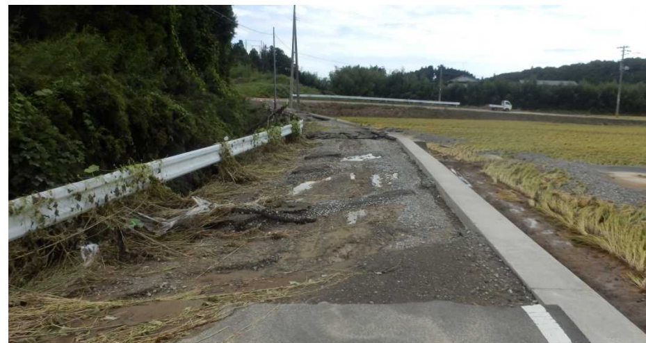
※背後道路(町道上綱木下原線) 及び水田の被害
