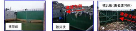
水門管理用水位計における河川津波高、不明 水門管理用水位計における河川位相高、T.P.7.6m 被災前後の水位の相違距離、約4m ゲート操作状況、不明(遠隔操作)
