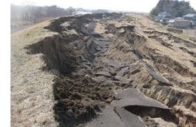
写真 2-17 鳴瀬川左岸 30.3k 地震による堤防沈下
