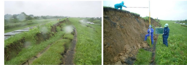
写真 2-11 宮城県北部地震による被害状況(鳴瀬川右岸13.0km付近)
