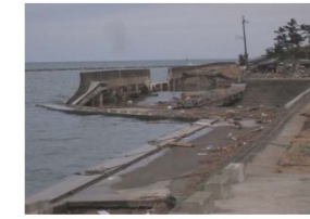
写真 2-16 鳴瀬川右岸 0.2k 津波による堤防流出
