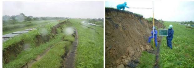
写真 2-10 宮城県北部地震による被害状況(鳴瀬川右岸13.0km付近)
