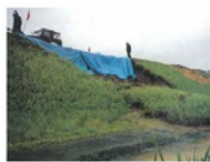
写真 3-7 堤防法崩れの状況
