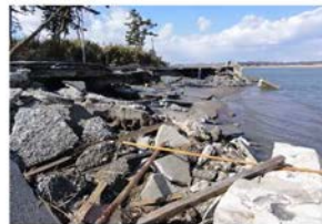
写真 2-14 鳴瀬川右岸 0.0k 津波による堤防流出
