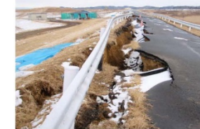
写真 2-18 吉田川左岸 14.7k 地震による堤防天端クラック
