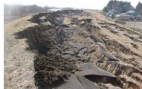
写真 2-16 鳴瀬川左岸 30.3k 地震による堤防沈下
