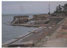
写真 2-15 鳴瀬川右岸 0.2k 津波による堤防流出
