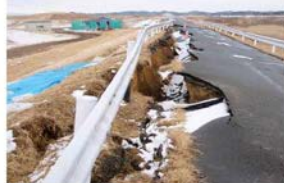
写真 2-17 吉田川左岸 14.7k 地震による堤防天端クラック
