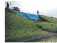
写真 3-7 堤防法崩れの状況
