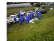
写真 3-8 漏水による水防活動の状況
