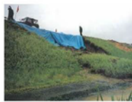
写真 3-7 堤防法雨れの状況
