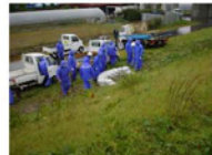
写真 3-8 漏水による水防活動の状況
