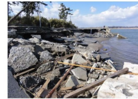
写真 2-15 鳴瀬川右岸 0.0k 津波による堤防流出
