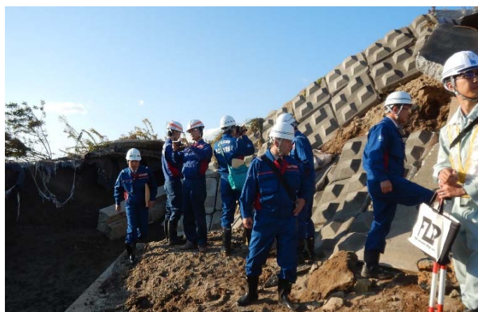
【吉田川決壊箇所 調査状況】
