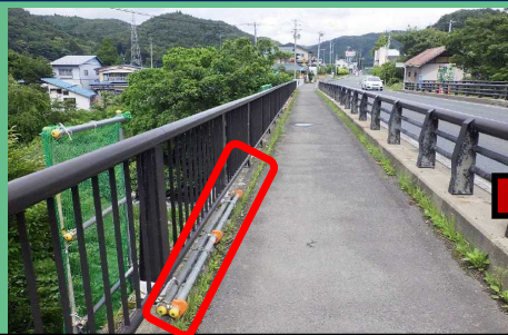
単管が剥き出しなので注意喚起が必要
