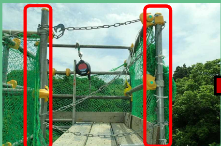
足場の梯子の手摺りに滑り止めがない
