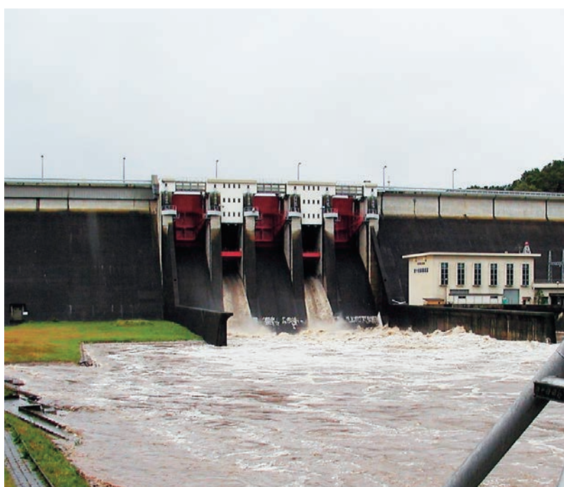
ダムによる洪水調節の状況（四十四田ダム）
