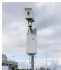
簡易型河川監視カメラ
