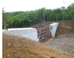
土石流発生前（H24年6月）
