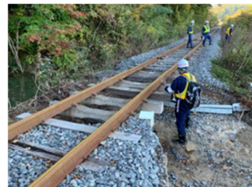
被災した鉄道施設の調査
