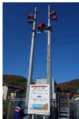
▲警報設備の確認の様子
