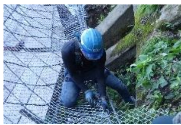
結合コイル取付状況
