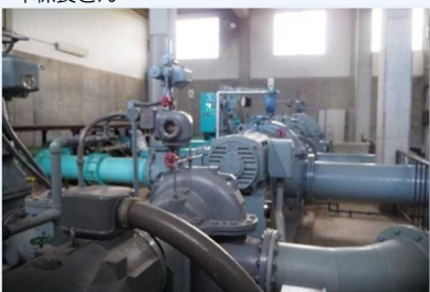
▲沈砂池から着水井(ちゃくすいせい) (※) へ原水を送るポンプ群。※水質を調べ水の濁りを固める凝集剤 (PAC)を入れるポイントが着水井
