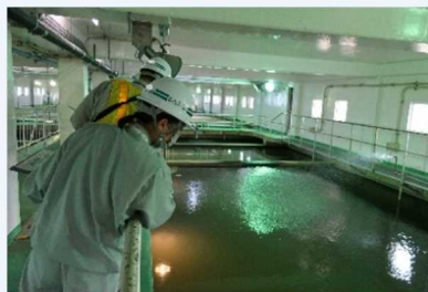
▲着水井を過ぎて、薬品沈殿池へ。小さい ゴミや濁りはPACに凝集され固まり下に沈 み、水は徐々に澄んできれいになります
