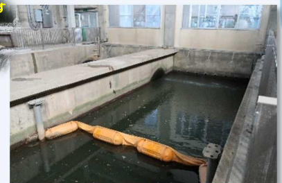
▲岩木川から取水した水は最初に沈砂池へ。 濁っていて汚れが目立つ状態
