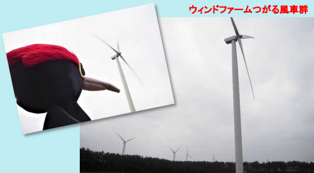
⑩ウィンドファームつがる風車群。2020年4月に運転を開始した日本最大級の風力発電所。12kmに38基の風車が並ぶ。見上げた時の大きさや音などは、体感の価値あり!
