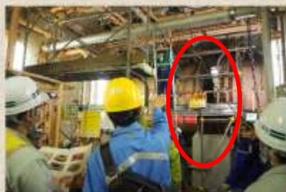
④この隙間は、ダムからの水を通す水圧鉄管の入口弁があった場所。現在は山形の工場で見学・部品交換作業中だそうです。
