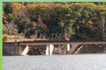
▲旧道の撤去されず残された橋普段は津軽白神湖の水の中です
