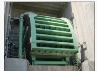
■ コンジットゲート
