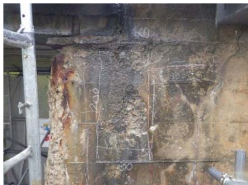
【変状】 堅壁の剥離・鉄筋露出・うき
