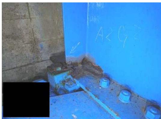
【損傷】 欠損を伴う腐食
