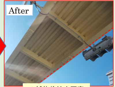
▲補修後拡大写真
