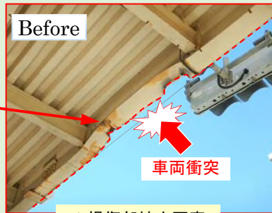
▲損傷部拡大写真
