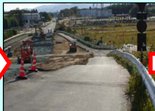
損傷により通行できなくなった橋を撤去。ランプ部にも大きな段差が見られた。
