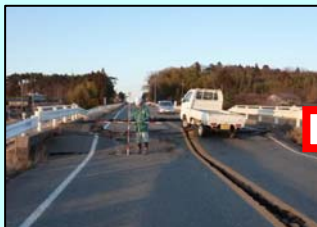
発災直後、段差で軽トラックが走行不能に。橋台にも損傷が確認されたため、全面通行止めを実施。
