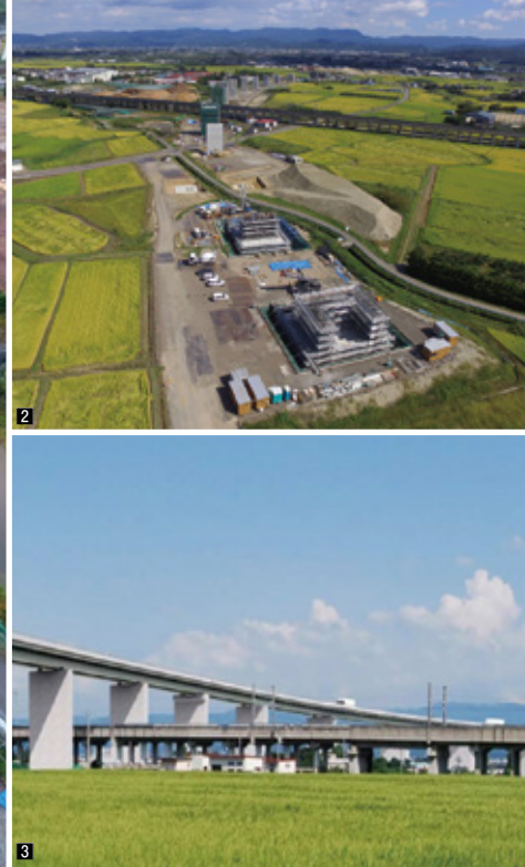
1 桑折高架橋(仮)の橋脚施工状況 2 桑折高架橋(仮)進捗状況 3 桑折高架橋(仮)完成イメージ図
