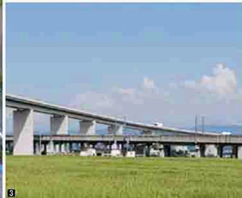
1 架折高架橋(仮)の橋脚施工状況 2 架折高架橋(仮)並移状況 3 架折高架橋(仮)完成イメージ図
